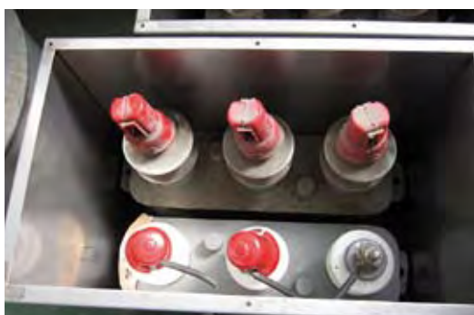
委託処分予定の高圧コンデンサ
