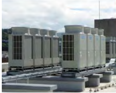
総合研究棟(文法経系)の高効率空調室外機
