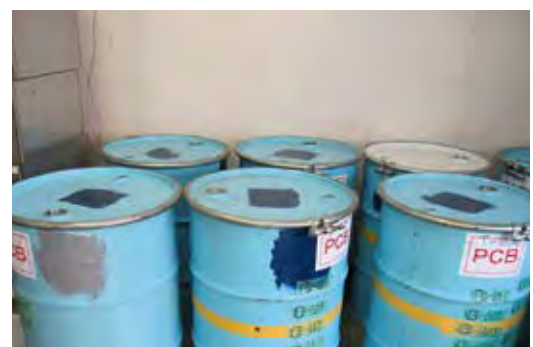
保管中の蛍光管安定器
