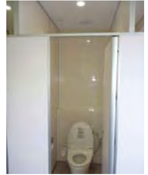
LED照明と節水型衛生器具
