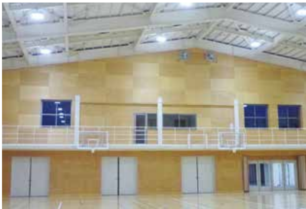
附属中学校 体育館 (LED照明・複層ガラス・高効率空調設備・全熱交換型換気扇・断熱防水)
