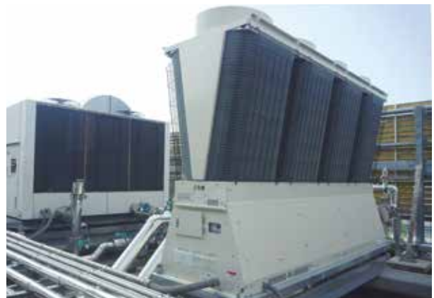
動物南施設 (高効率空調機)
