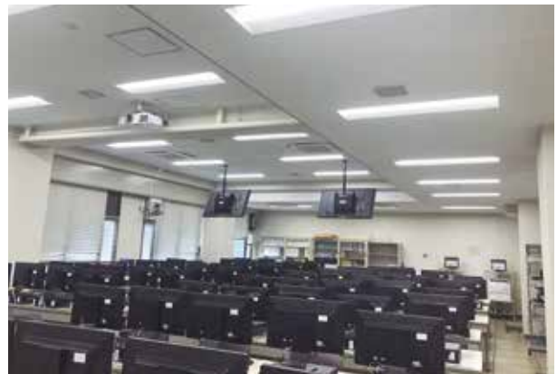
工学部 4号館 講義室 (LED照明)
