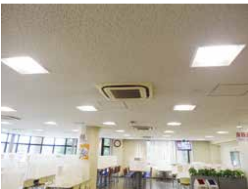
(津島) 南福祉施設棟 (LED照明)
