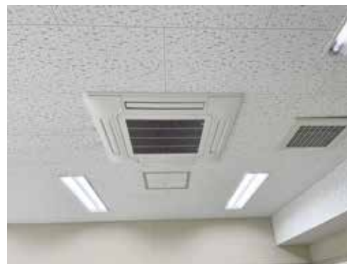
(津島) 理学部本館 高効率空調設備
