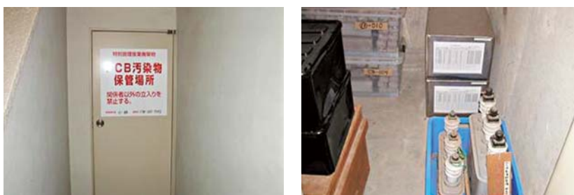
ポリ塩化ビフェニル廃棄物の保管場所の掲示と保管状況
