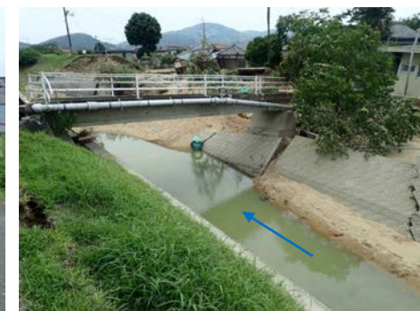
橋梁下流の右岸被災状況
