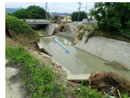
橋梁下流の右岸被災状況
