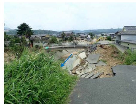
橋梁下流の左岸被災状況
