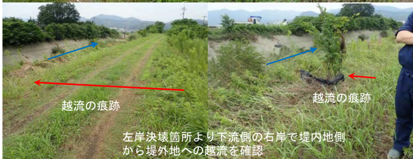
左岸決壊箇所より上流側の右岸で外水の越流を確認
