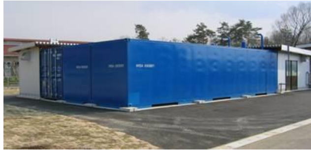
メタン発酵槽
